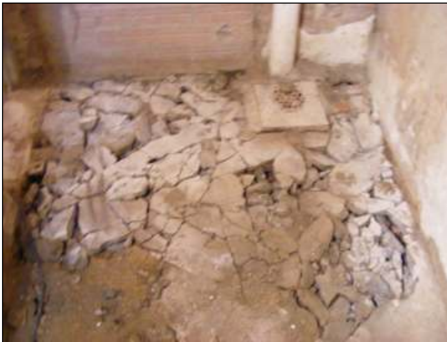
Fig. 11.- Procés d'afectació del paviment U.E. 100.
